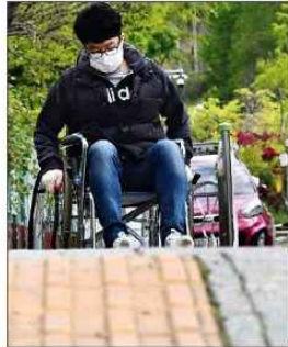
20일 부산 남구 장애인복지관 인근에서 국제신문 김민주 기자가 휠체어를 타고 보도 상태를 점검하고 있다. 김성효 전문기자
